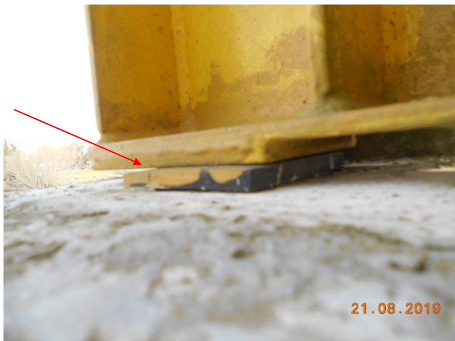
Foto 24 Aparelho de apoio AA31, mal posicionado e com deficiência de contato.
