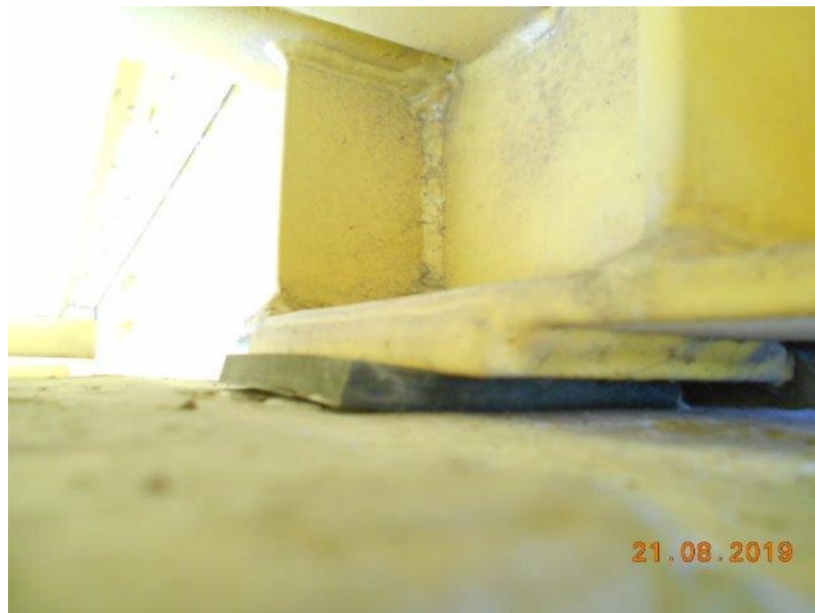
Foto 33 Aparelho de apoio AA48 deformado.
