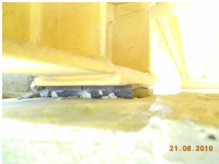
Foto 34 Aparelho de apoio AA51 deformado, instalado em pedaços isolados e justapostos para atingir a altura necessária.
