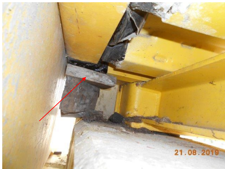
Foto 26 Vista do aparelho de apoio AA35 (travessia) obstruído, porém com início de ressecamento. Notam-se restos de escoramento provisório
