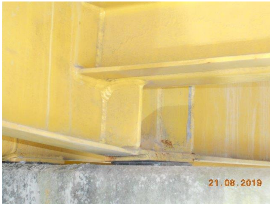
Foto 39 Aparelho de apoio AA62 em bom estado.
