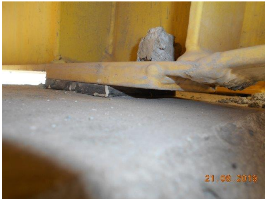
Foto 15 Aparelho de apoio AA2 em bom estado.
