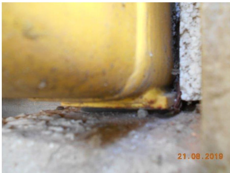
Foto 40 Aparelho de apoio AA67 obstruído.
