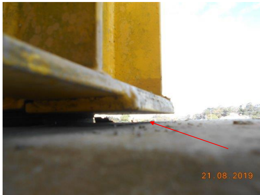
Foto 25 Vista do aparelho de apoio AA32 inexistente.
