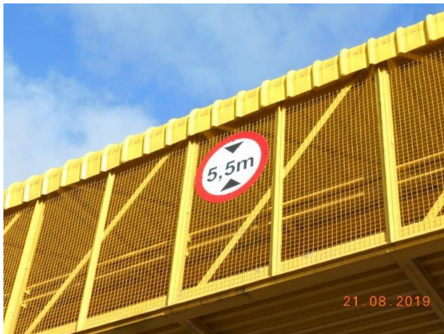
Foto 06 Idem foto anterior – Vista em detalhe para placa de sinalização de gabarito vertical na pista marginal Norte.
