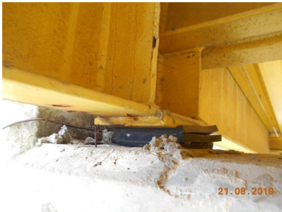
Foto 16 Aparelho de apoio AA5 mal posicionado devido à falta de berço. Foram instalados três aparelhos justapostos para atingir a altura necessária.
