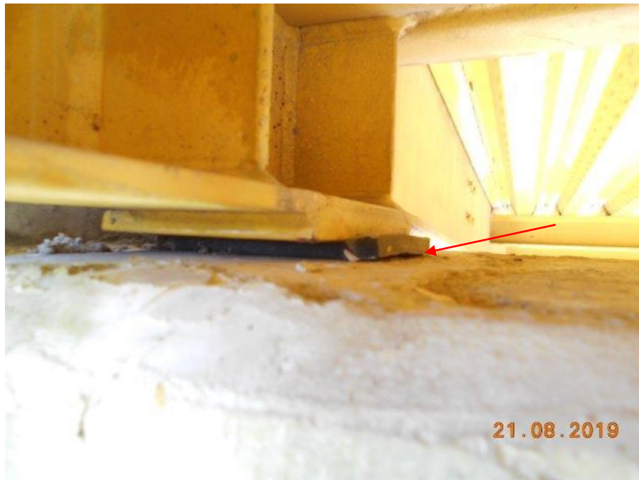
Foto 23 Aparelho de apoio AA27 com deficiência de contato.
